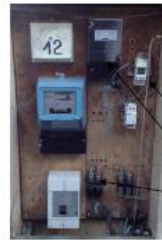
Armoire de commande d'éclairage public
