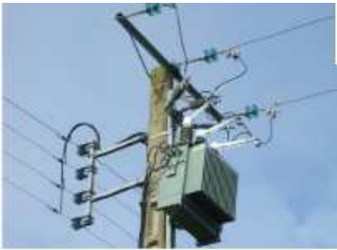
Transformateur aérien H61
