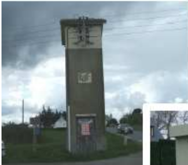
Transformateur cabine haute
