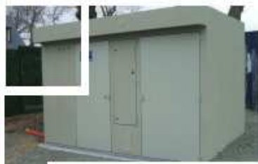
Transformateur cabine urbaine
